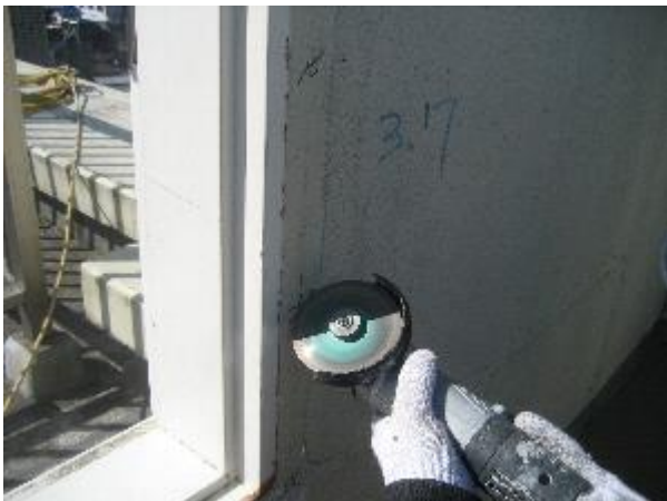
外壁ひび割れエフロ箇所
