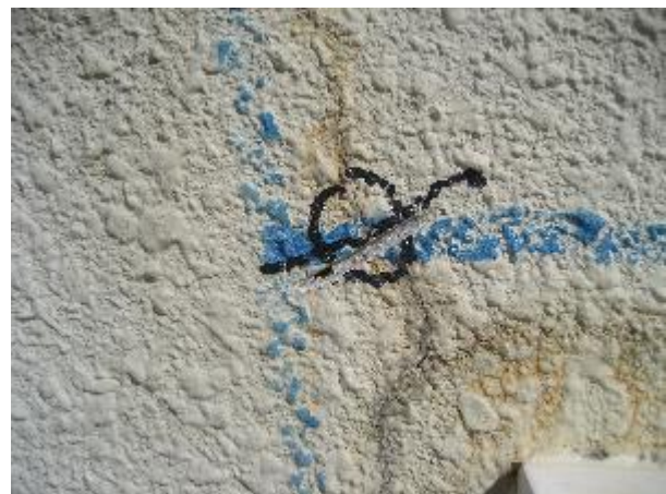
エフロ箇所をクロスカットした状態
