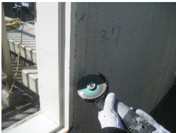
外壁ひび割れエフロ箇所
